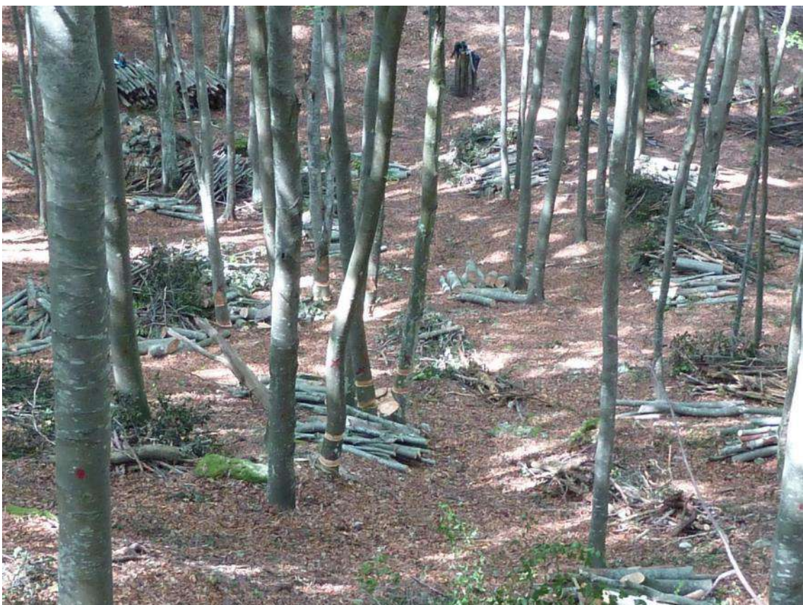
Vista d'insieme dell'area di cantiere. In alto, sullo sfondo, una delle log pyramid realizzate
