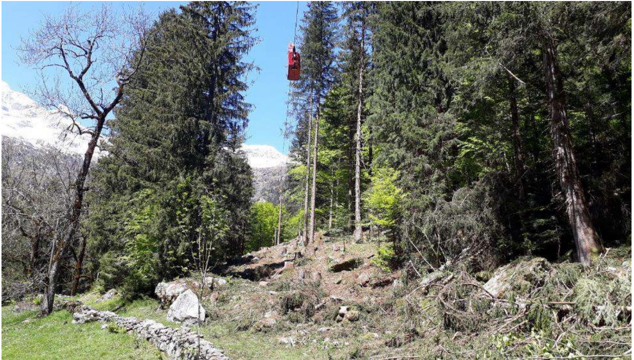
Foto 1 – Una delle due linee di teleferica installate
