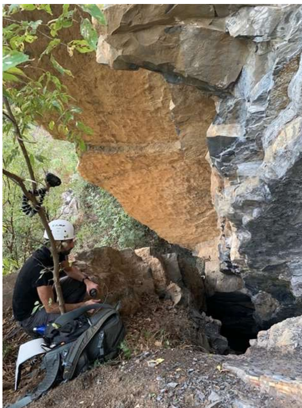
Figura 4 – Ingresso della Miniera di Zu. Il blocco di roccia visibile sulla sinistra si è recentemente staccato dalla volta dell'ingresso.
