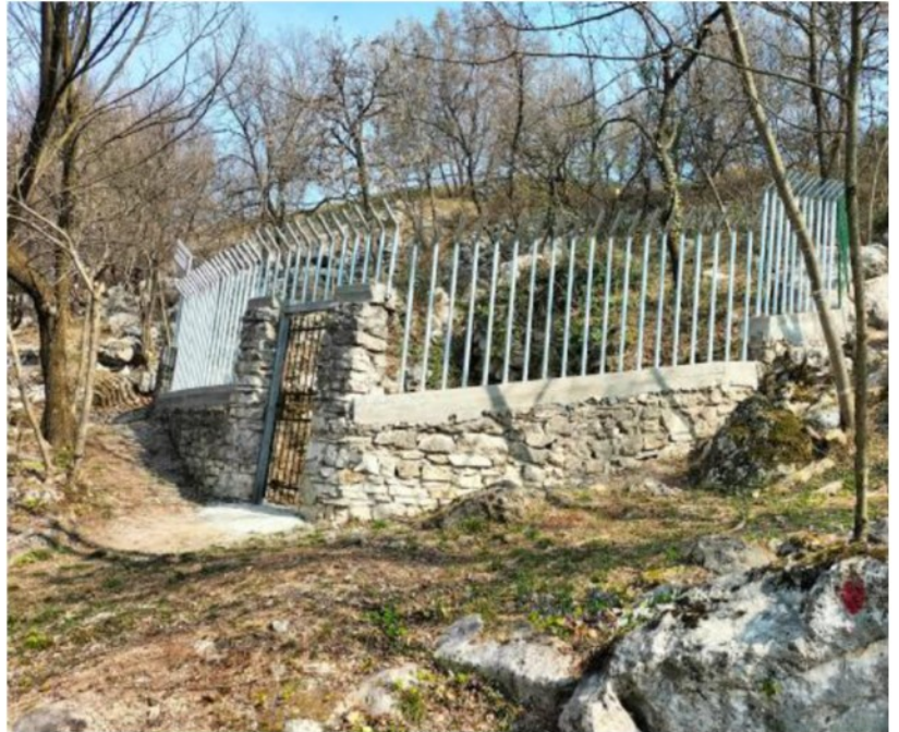
La nuova recinzione anti intrusione realizzata attorno al Buco del Frate in territorio di Prevalle
